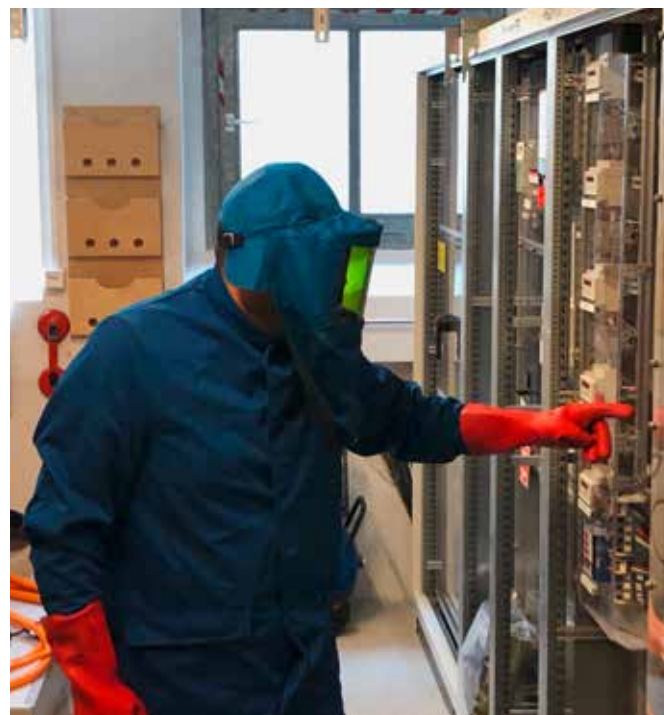
Schaltvorgang in der Hauptverteilung der Kaserne.
